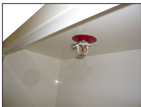
Système d'extinction automatique
