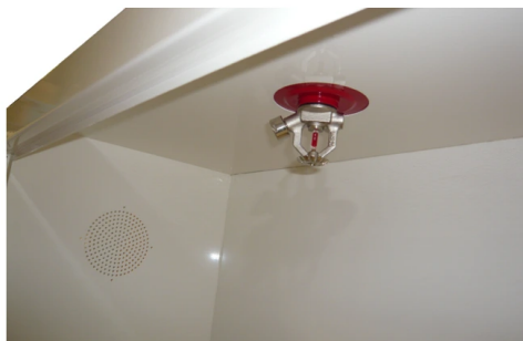
Système d'extinction automatique
